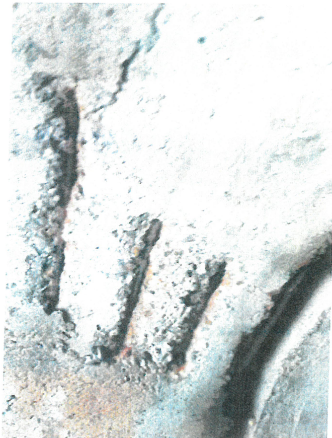
fot. 4 – Nitka 1 przepustu, korozja prętów zbrojeniowych
