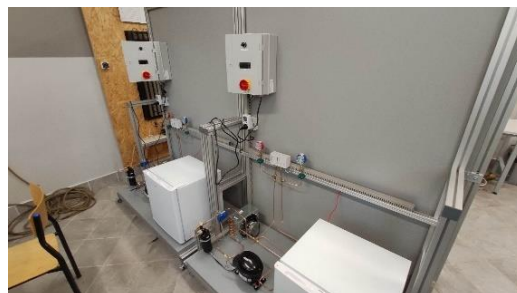
Zdjęcie 10. Zakup sprzętu do Pracowni chłodnictwa w CKZ w Bażanowicach – stanowisko demonstracyjne – pompa ciepła
